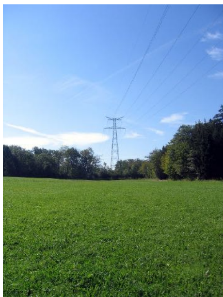
Ligne à haute tension
